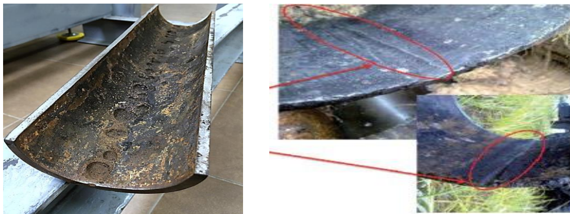
Рис. 1. Типичный вид места поражения промышленного нефтепровода в результате «ручейковой» коррозии
